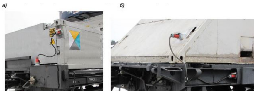
Рис. 3. Примеры подключения АДГУ к сети электроснабжения платформы: а – подключение АДГУ «Прогрессор-01»; б – подключение АДГУ РКВ-15
